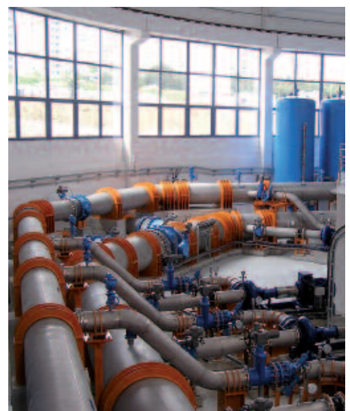
Slika 3. Crpna stanica Ravne Njive
